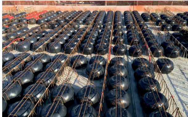
Abb. 14 - Bewehrung mit Kunststoff Hohlkörpern
